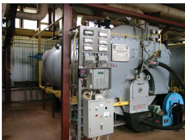
Рис. 3. Современный жаротрубный котел КВЖ-2-115Г с системой автоматизации КСУ МАК.
