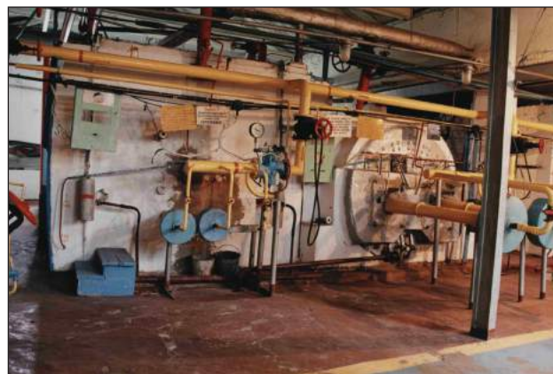
Рис. 1. Общий вид котлов в ликвидированной котельной № 41 г. Дзержинска.
